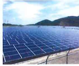
富津ソーラー発電所
